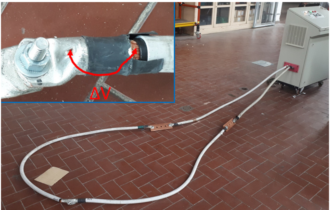
Figura 1: layout di misura e dettaglio dei punti di misura per la caduta di tensione
